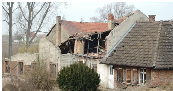
Gebäude zerfallen ungenutzt.
